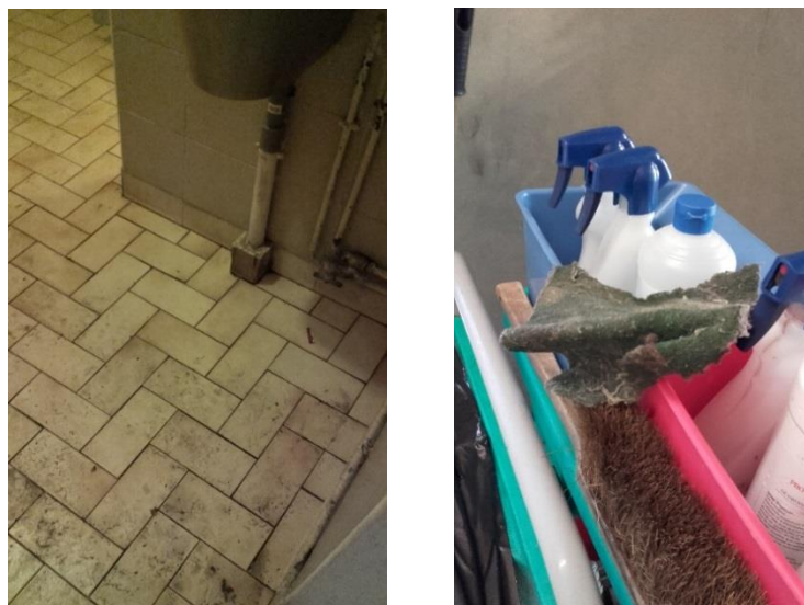
Saleté des locaux et du matériel de nettoyage
