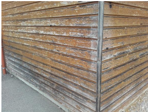
Usure du bâtiment d'activités
