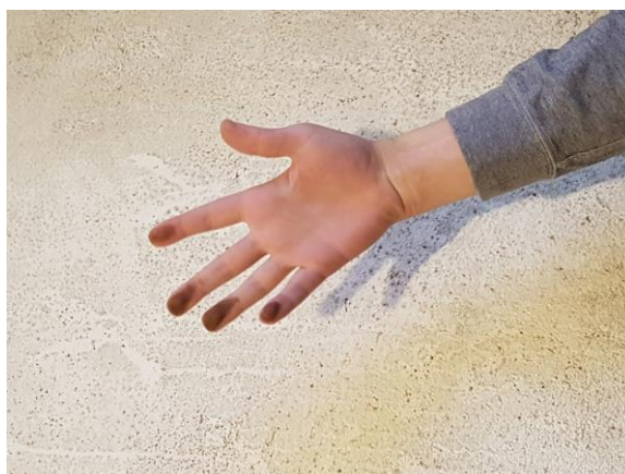
Fortes traces d'humidité
