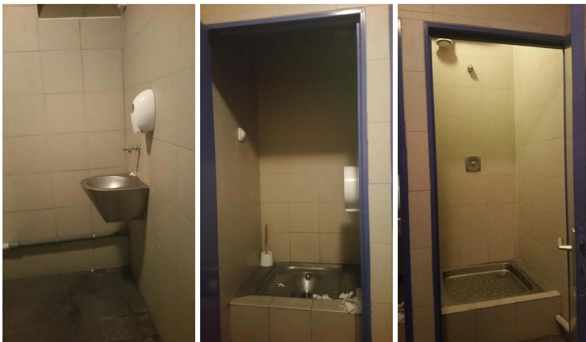
Le coin toilette de la zone de garde à vue
