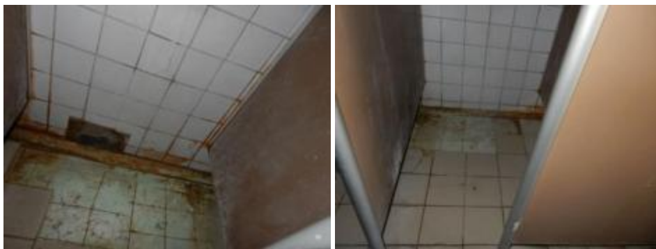
Sols de douches dégradés
