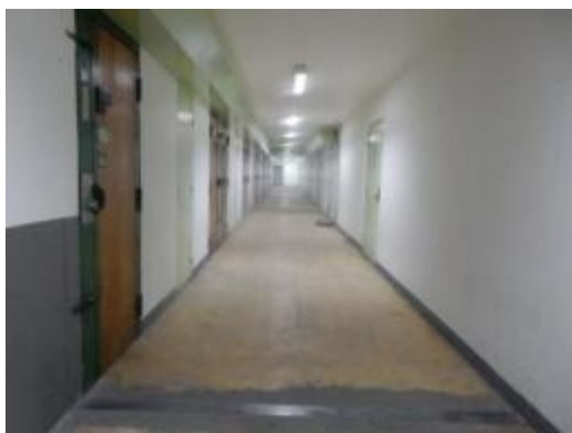
Sol en « Duralite » endommagé
