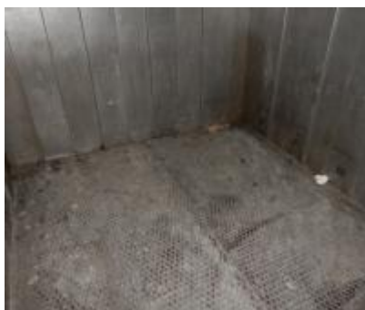
Ascenseur de bâtiment
