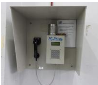
Poste téléphonique sur une coursive
