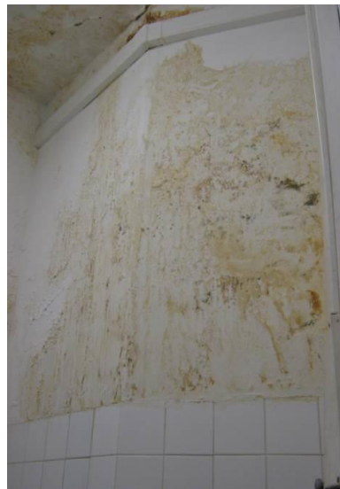
Les traces d'humidité sur les murs d'un couloir de la 3 ème division
