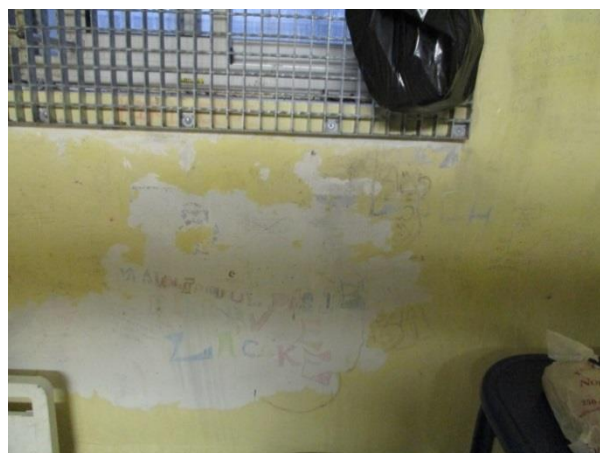
Traces d'humidité en cellule
