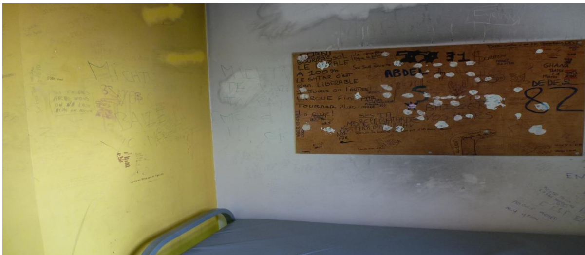
Panneau en contreplaqué couvert de graffitis
