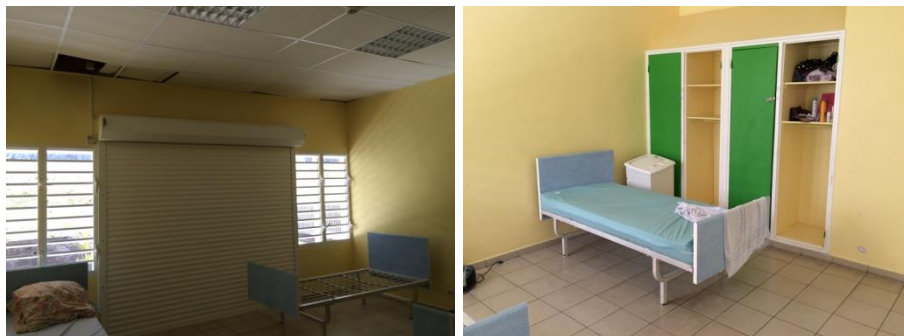
Chambre à trois lits avec volet roulant fermé et placards dont deux sans porte
