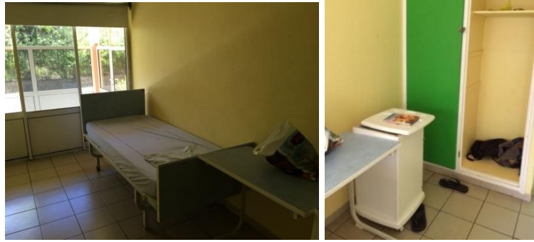
Chambre individuelle avec table de nuit détériorée et placard avec porte manquante
