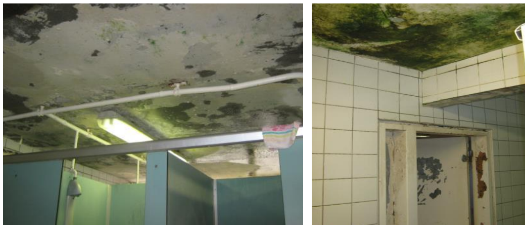
Le plafond fortement endommagé, avec des moisissures
