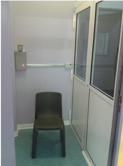
Cabine de parloir hygiaphone
