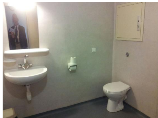
Toilettes de la chambre d'isolement
