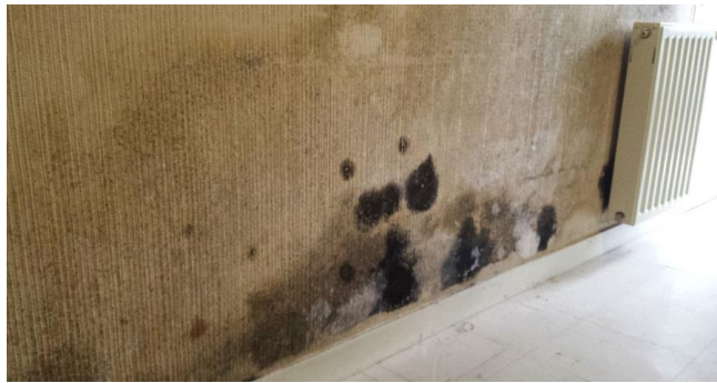
Moisissures dans la chambre des femmes
