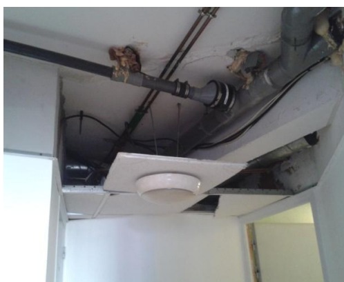
Faux plafond absent à l'entrée d'une cellule
