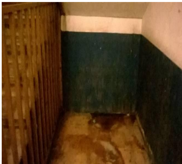
Bas de la cage d'escalier du bâtiment C, avec une flaque d'urine
