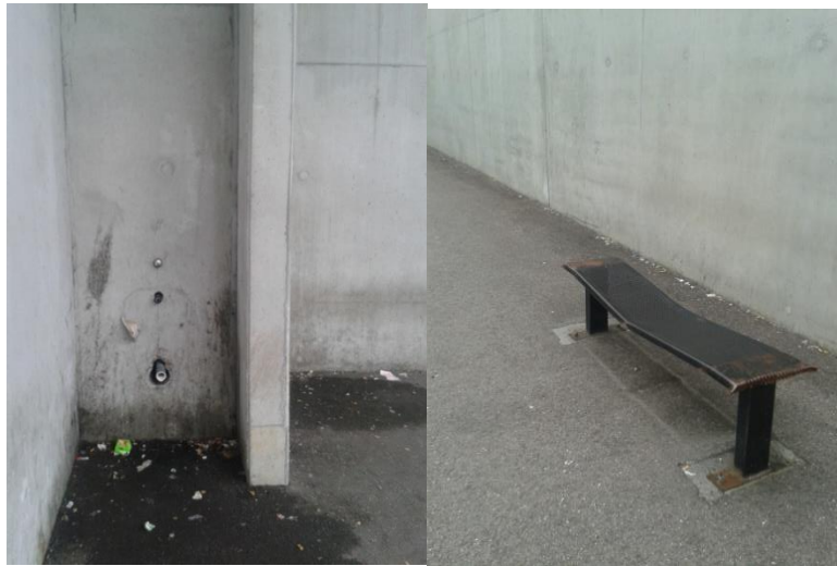
Vue du WC manquant
