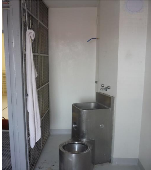
Vue de la partie sanitaire d'une cellule du QD
