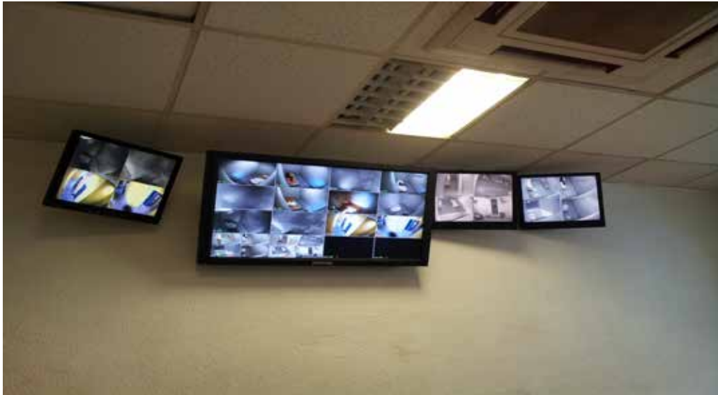
Ecrans de vidéosurveillance dans le hall du service des écrous
