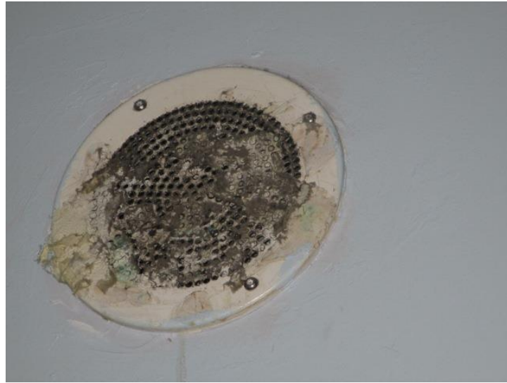
Ventilation dans une chambre
