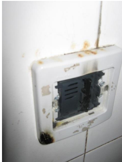
Vue de l'interrupteur électrique du bloc du 3 ème étage
