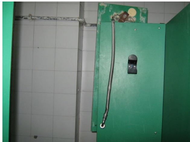
Vue d'une douche du bloc du 3 ème étage sans robinetterie
