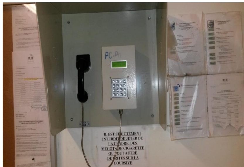
Point phone dans un couloir
