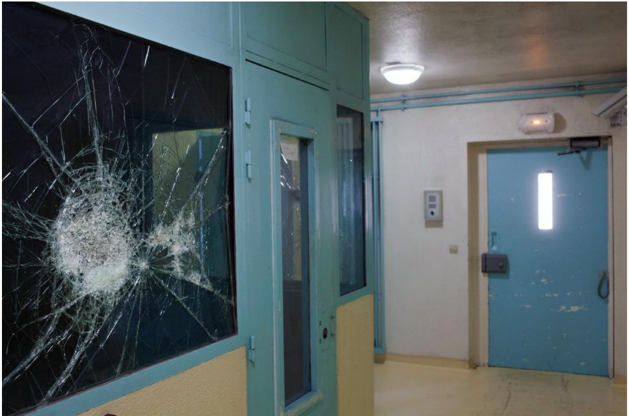
Vitre du bureau du surveillant du quartier disciplinaire et d'isolement après la mutinerie
