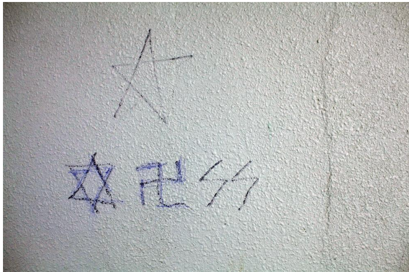
Graffitis dans une cage d'escalier
