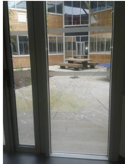
Une vitre endommagée
