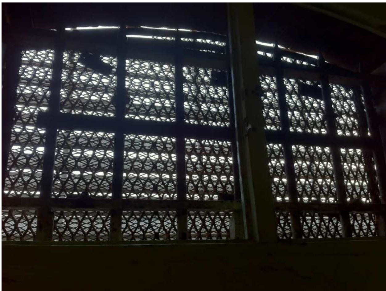
Fenêtre équipée d'une quadruple obturation
